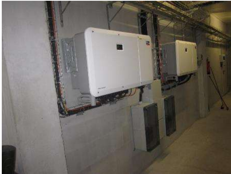
Wechselrichter > 100 kW und Batteriespeicher > 100 kWh
